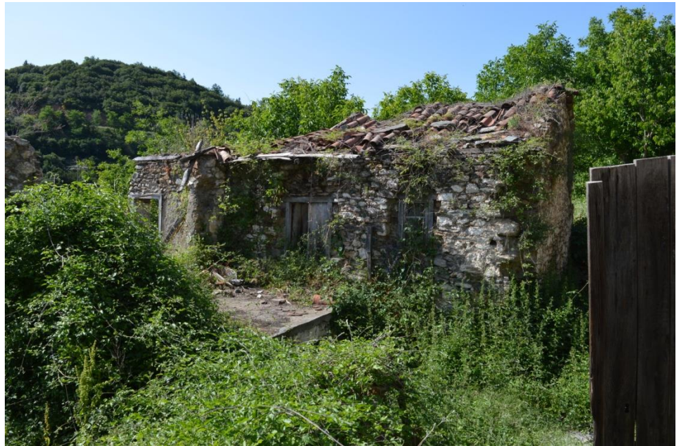
Σχ. 49. Παραδοσιακή ισόγεια κατοικία, εγκαταλειμμένη, σε ερειπιώδη κατάσταση
