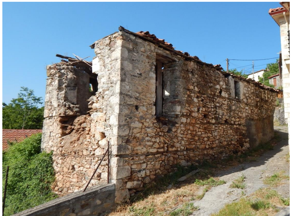
Σχ. 50. Παραδοσιακή ισόγεια κατοικία, εγκαταλειμμένη, σε ερειπιώδη κατάσταση
