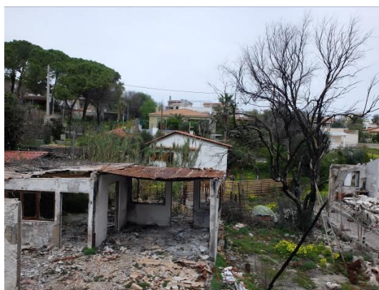
Εικ.1.6. Κτίσμα σε πολύ κακή κατάσταση, τισμένο στην κοίτη του ρέματος του Παππά.
